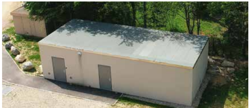
▪ Un des premiers Nœuds de Raccordement Optique construit sur la Communauté de Communes ▪
